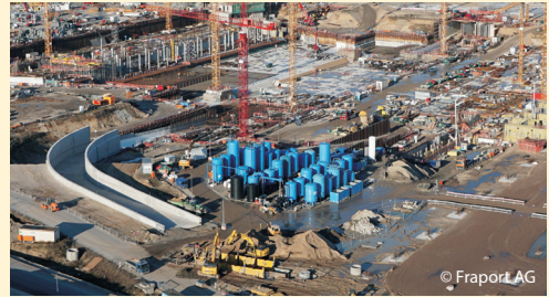
Bauwasseraufbereitung und Wasserhaltung am Terminal 3 in Frankfurt.
