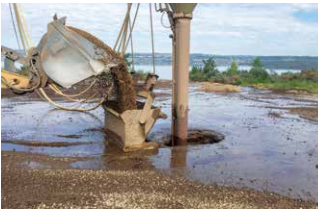
Foto 1: Verschlammung der Arbeitsebene des Trägergerätes durch die Austritte des Zugabewassers
