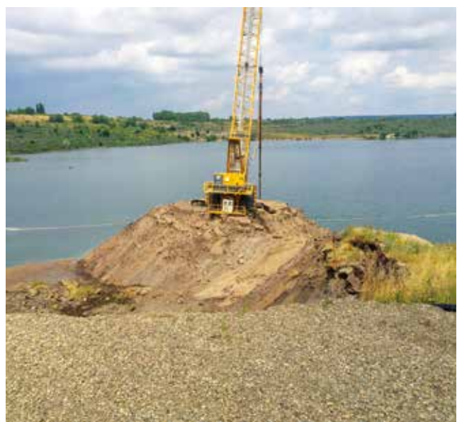
Foto 6: Trägergerät LR 1300 nach der Rutschung
