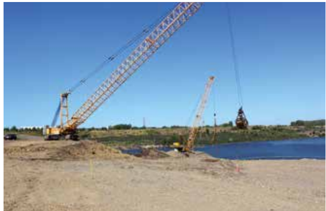
Foto 6: Einsatz des Hydroseilbaggers HS 895 zur Kopffentlastung (links) am 24.08.2016 (havariertes Trägergerät TG 3 rechts)
