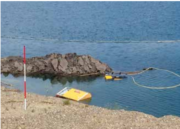
Fotos 7+8: Sicherungsraupe und Teile der Baustelleneinrichtung nach der Rutschung
