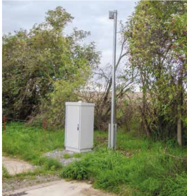
Foto 2: Seismischer Messpunkt am ehemaligen Klärwerk der Fa. NOVELIS
