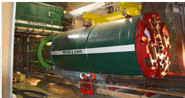
Bild 6: Montage der TBM auf der Schildwiege, dahinter Presseneinrichtung mit sechs Hydraulikzylindern für 2 500 t Schubkraft, darüber Steuerstand für den Vortrieb
